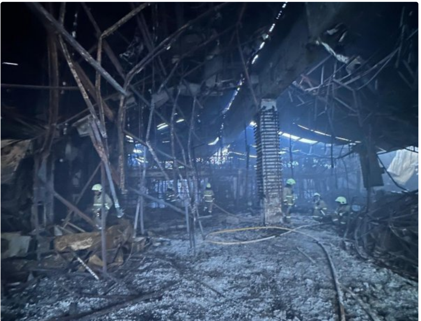
Glodok Plaza yang Hangus Terbakar
